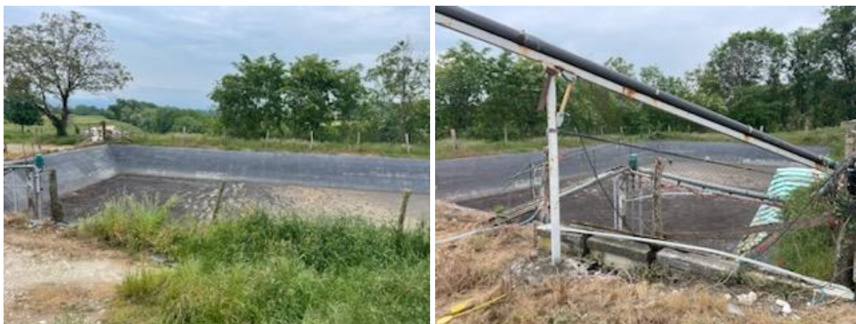
Figure 18 : Photos de la cuve de stockage déportée de digestat au GAEC FLY
